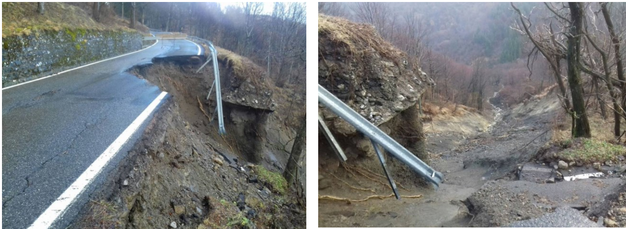
Fig.5: smottamento evoluto in colata di fango a valle della SP 91 nei pressi di Casenove (Ligonchio, RE). A destra foto scattata dal piano stradale verso il basso. Foto della Provincia di Reggio Emilia.
