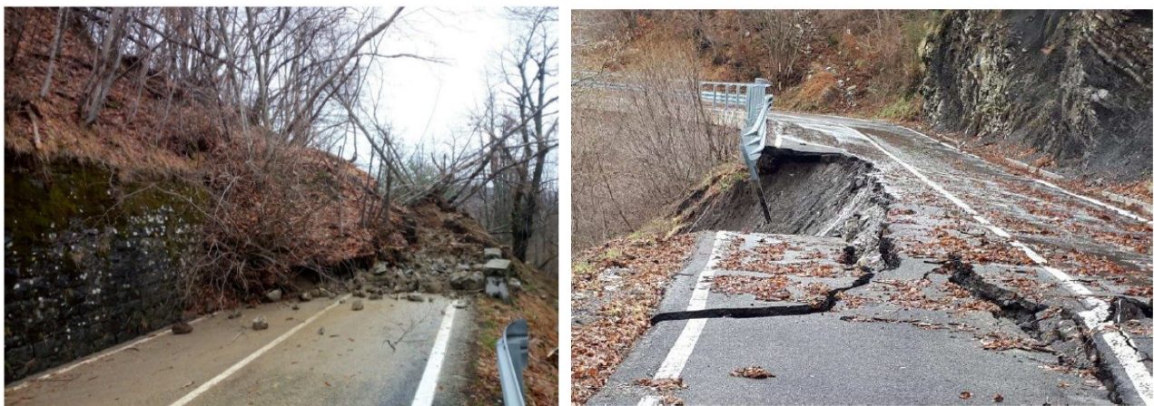
Fig. 4: smottamenti lungo la SP 15 in comune di Ventasso (RE) nei pressi di Miscoso. A sinistra all'altezza del Km 24,650; a destra all'altezza del Km 25,200. Foto della Provincia di Reggio Emilia.
