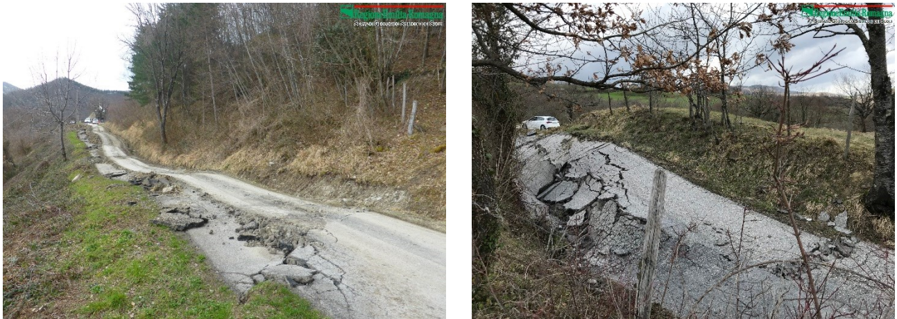
Fig. 26: strade danneggiate sulla frana di Corneto (Verghereto, FC): a sinistra zona di coronamento. a destra zona medio bassa dell'accumulo (nei pressi del tornante stradale in Fig. 25).
